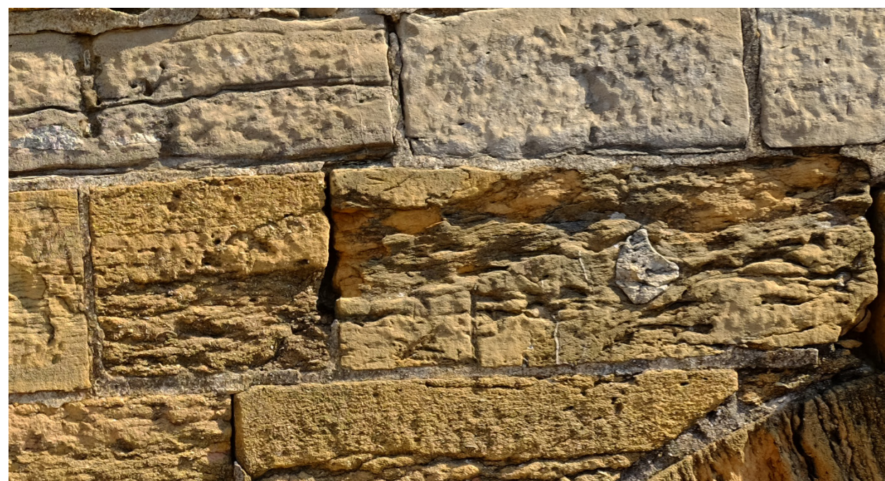
Dzsquamation de parement de la façade sud
