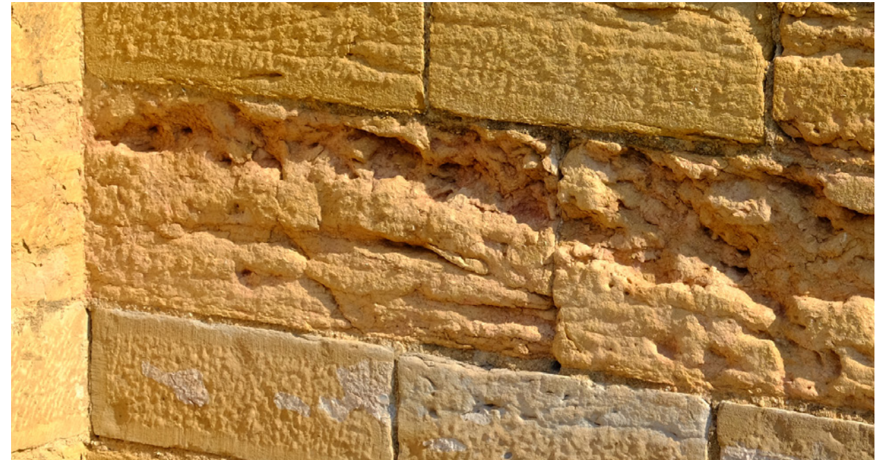
Désagrégation de parement de la façade sud
