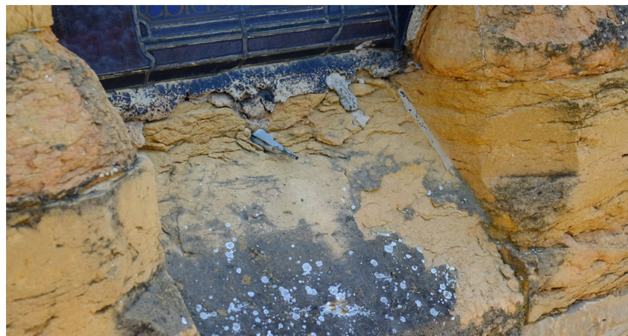
Délitage d'un appui de baie de la façade ouest
