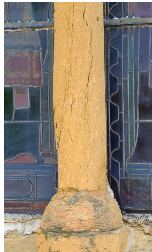
Délitage d'une colonne de la façade ouest
