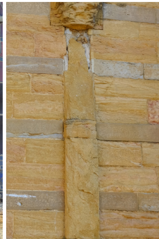
Délitage d'un pilastre de la façade sud
