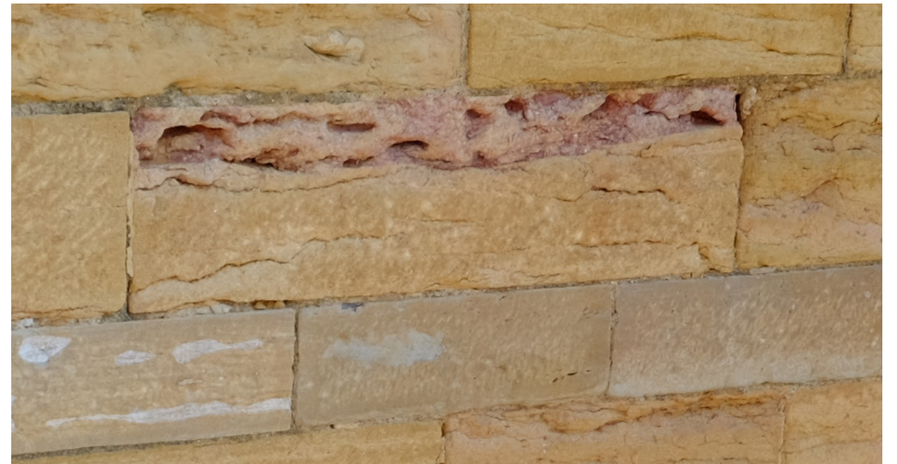
Désagrégation de parement de la façade sud
