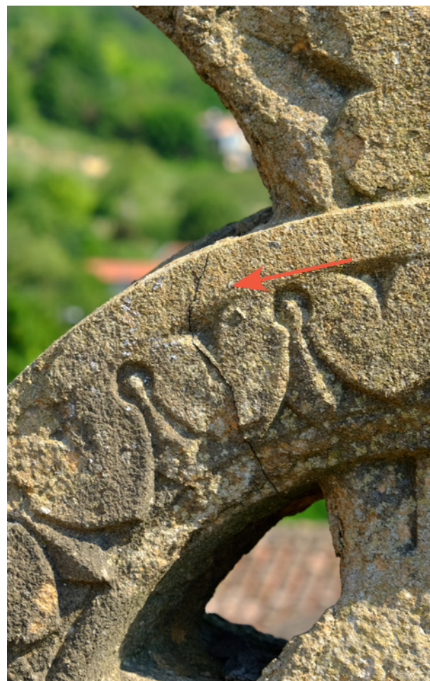
Fissures sur la croix de la façade sud
