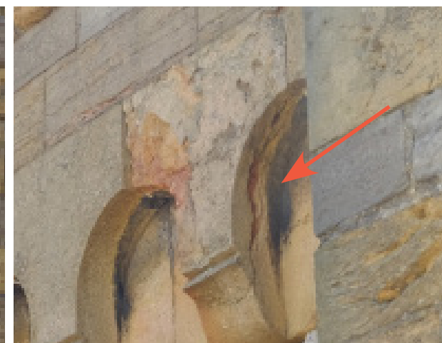
Bloc de bande lombard posée en délit, fissuration importante
