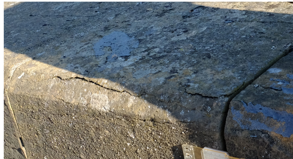
Délitage d'une couvertine du fronton de la façade sud
