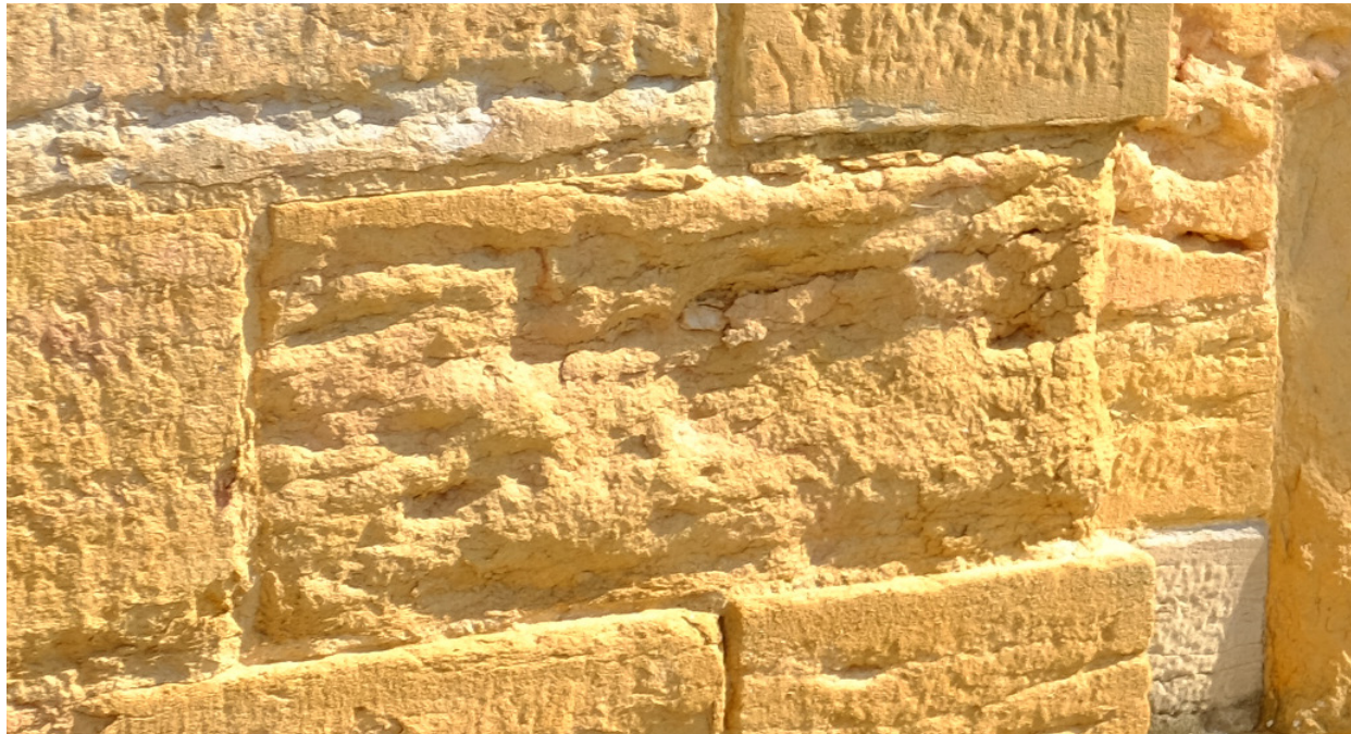
Désquamation de pierres de contrefort de la façade sud
