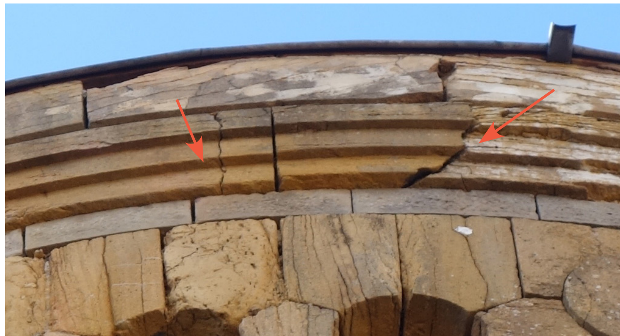
Fissures et fractures sur les pierres de corniche de l'abside
