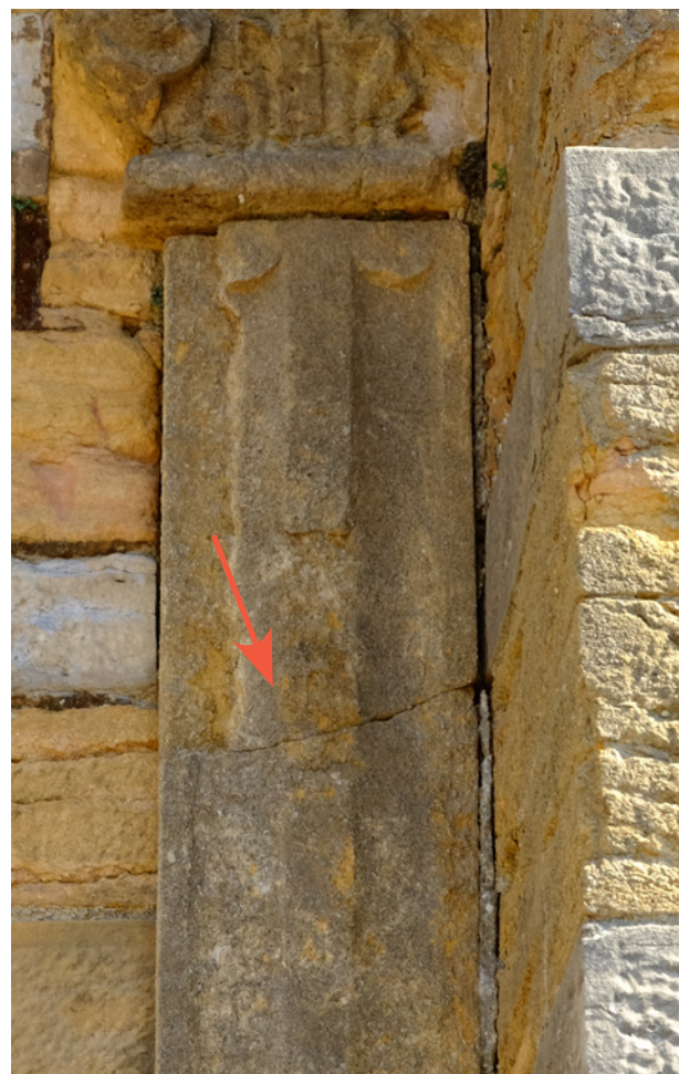
Fissures sur un pilastre de la façade sud
